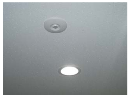
省エネ・節電器具の設置 (人感センサーとLED照明)
