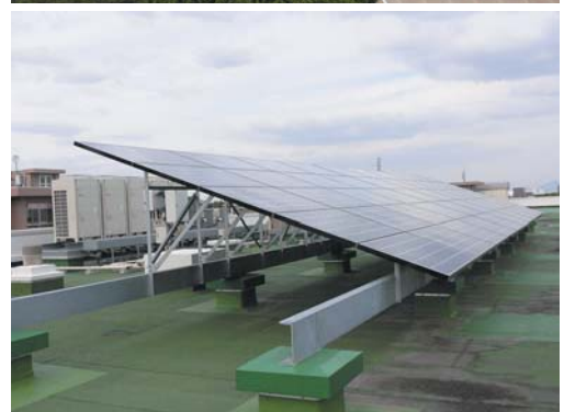
太陽光発電設備（文化教育学部9号館屋上）
