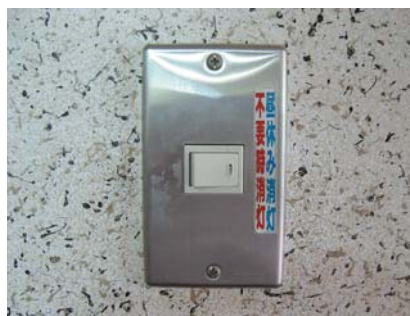
省エネ・節電の取組み (事務室等居室の消灯)
